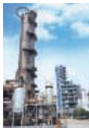
アンモニア製造プラント
